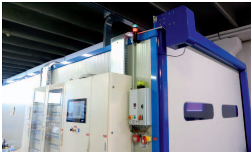
L'area 'a caldo', con visibile il quadro elettrico e il pannello dell'interfaccia Scada, dove sono effettuati test e collaudo dei chioschi di gaming destinati al mercato degli Stati Uniti
